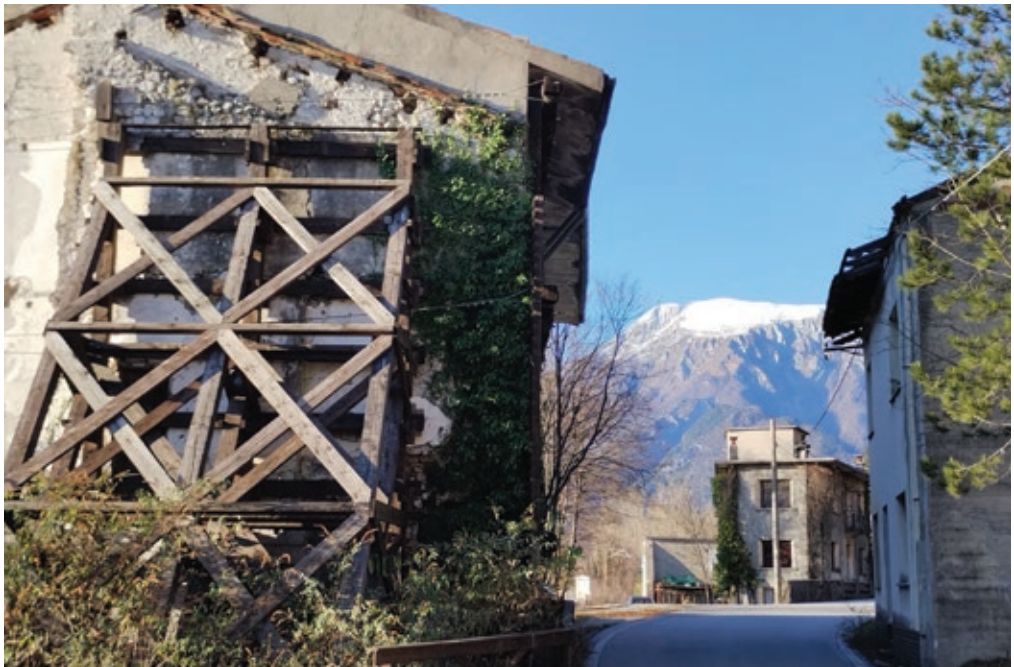
Fig. 55 - Edifici pericolanti ed abbandonati del paese di Portis (Portis vecchia), disabitato dopo i terremoti del 1976.
